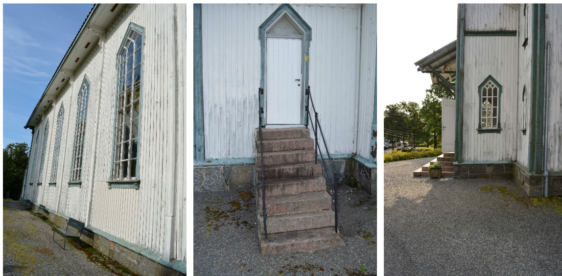
Bilde 1: Sørøstre vegg er mest utsatt for vær og vind og er den veggen med størst behov for renovering. Setningsskadene viser bl.a. tydelig på trappen til sakristiet (bilde 2) og til tårnfot (bilde 3).
