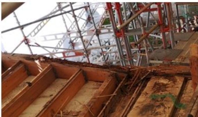
Noen av de bærende dragerne har en del råteskader
