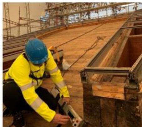
Med råteboring har vi avdekket at råten går 50cm inn i bærebjelken.
