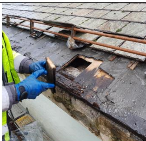
På grunn av feilkonstruksjon råtner nederste del av taket, og vann trenger inn i veggene
