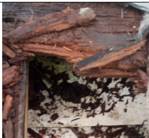
Taket på et mellombygg i Åsane kirke trenger sårt ny tekking, deler av undertaket har allerede begynt å råtne.
