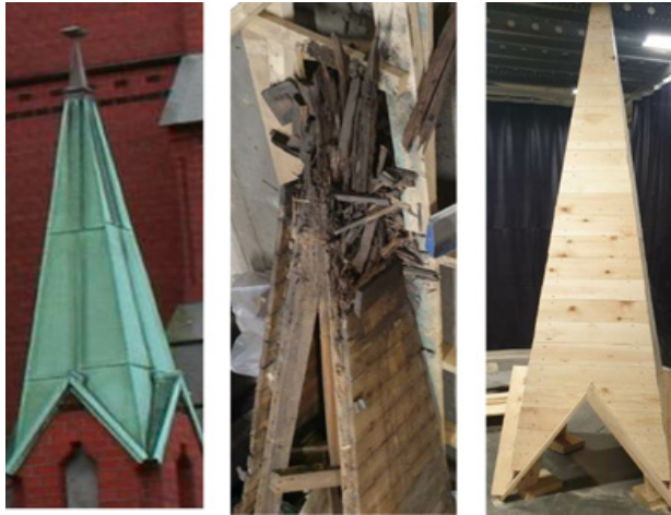
Johanneskirken: Når kobberen fra 1894 tas bort fra ulike spir, ser vi at treverket er råttent og trenger utskiftning. Foto: BKF
