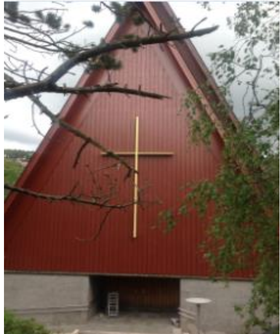
Biskopshavn kirke: Bildet viser ferdig vegg i forgrunnen, limtreet vi begynner med nå vises i bakgrunnen
