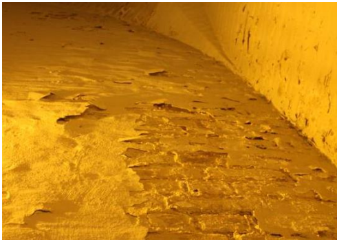
Storetveit kirke – maling og puss flasser pga fuktighet i veggen
