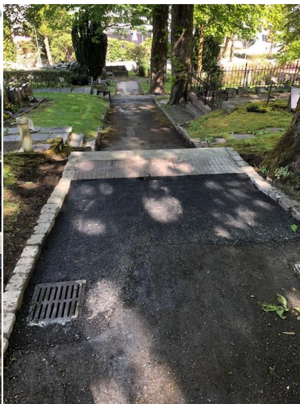
MØLLENDAL - TRAPP - VENTER PÅ REKKVERK
