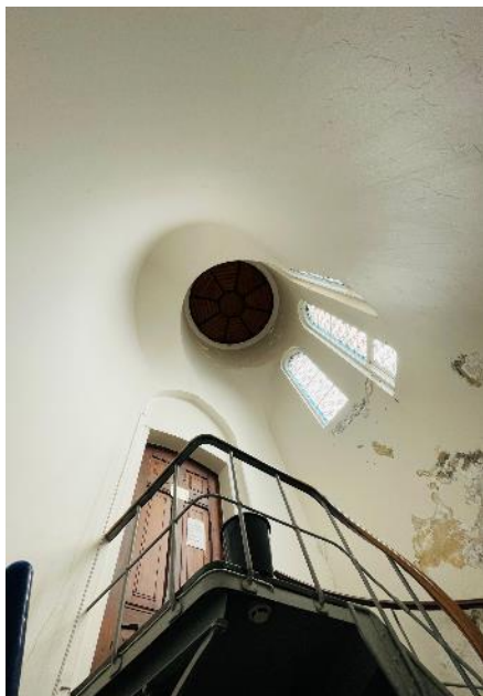
Bilde 46, Trappetårn opp til søndre galleri. Overflatene er pusset og malt og har store skader. Det er lekkasje fra taket som medfører innsig av vann inn langs vegg og ned på trapp.. De gule flatene er den gule fargen på kalk og oljemaling.
