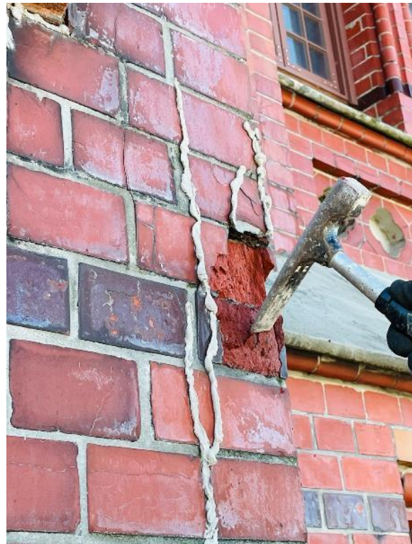
Bilde 33, Frostsprengt glasert tegl og sprekker
