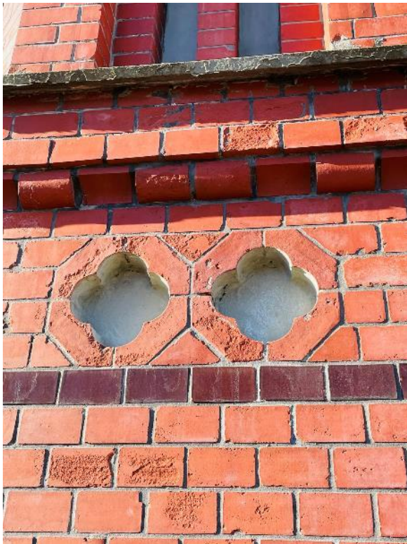
Bilde 32, Frostsprengt tegl
