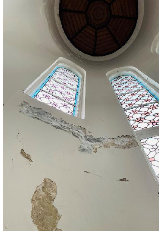
Figur 24, Tydelige saltutfellinger i underkant av vinduer i trappetårn.
