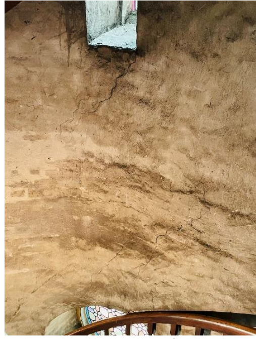
Figur 28, Original kostrappet overflate i nordvestre sidetårn til hovedtårnet. Pusset er sliten men det er ikke saltutfellingene.
