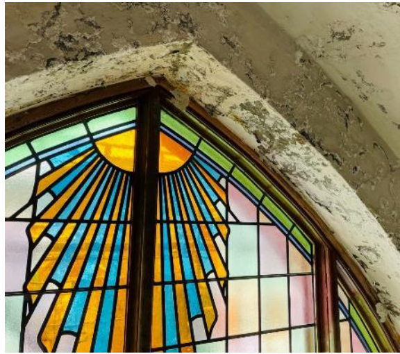
Bilde 61. Fuktinntregning rundt vinduskarm gir malingsavflassing, saltutfelling, og råte i treverk. Tilstand på vinduer er egen rapport.
