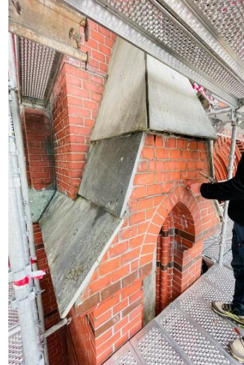
Bilde 55, Avdekkinger på småtak er med skifer uten fuge og fuksikring.
