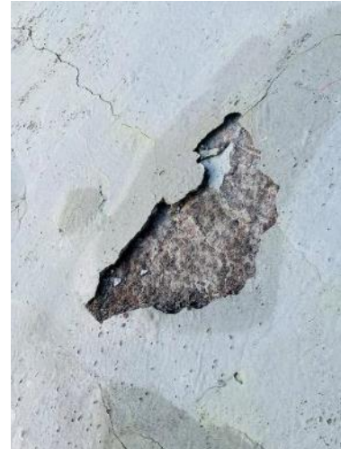
Bilde 29, malingen har sprekker og holder på fukt framfor å beskytte den porøse betongen under.
