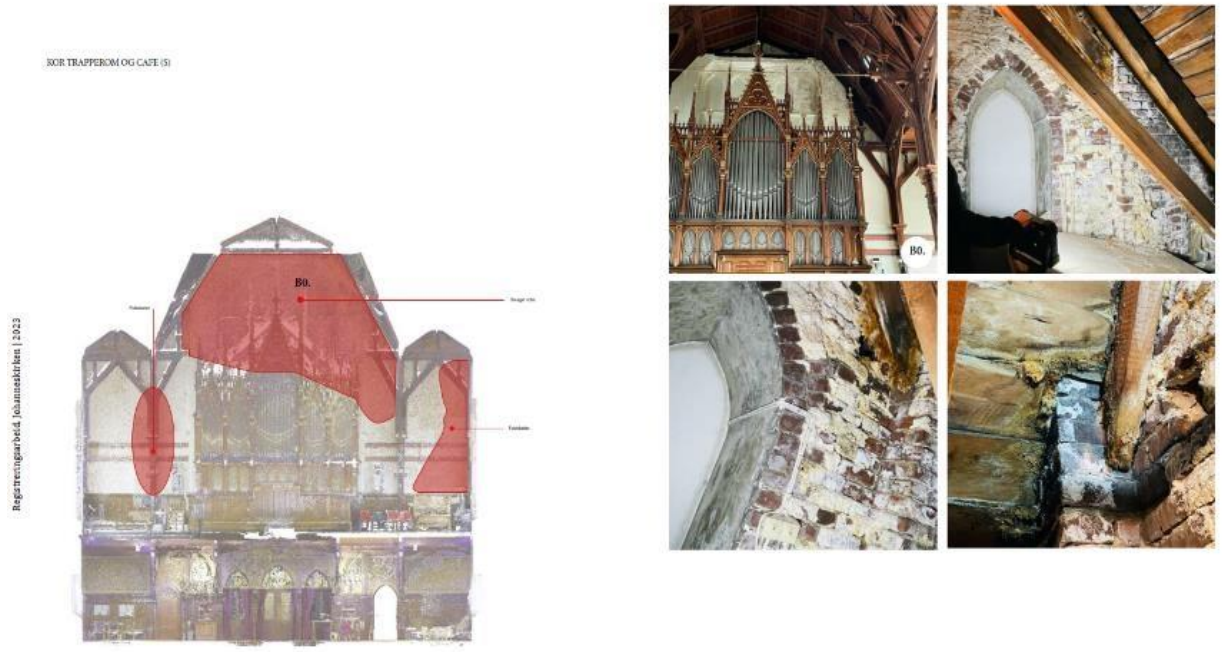
Figur 22, Fukt interiør. saltutfellinginger over orgel i skip og i loftskonstruksjon. Råteskader på takbjelker hvor tre møter mur. Se Tilstandsregistreringen, 2023, side 44
