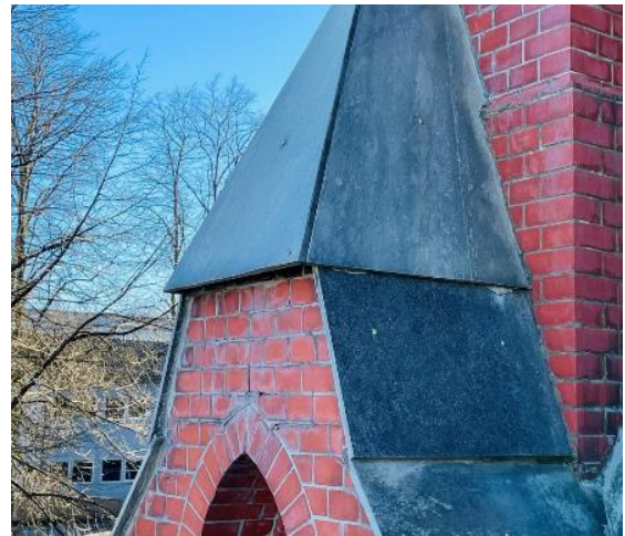
Bilde 26, Manglende fuktsikring i skjøter. Dette taket er lagt på ny i 1990 og er lagt i betong/skiferlim og plagget. Pluggene er ikke fukttettet.
