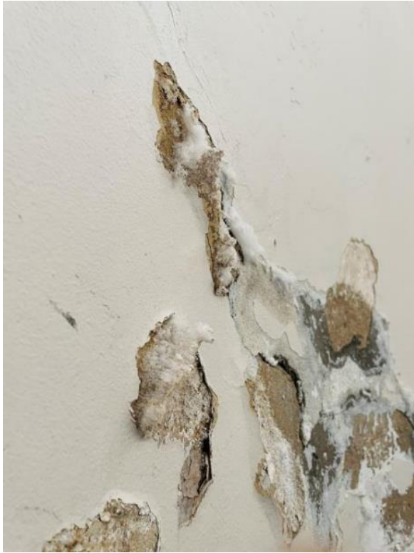
Figur 23, Salt ( \text{NaSO}_4 \times 10\text{H}_2\text{O} ) sprenger gjennom murverket, gjennom puss og slipper ikke gjennom tett maling.
