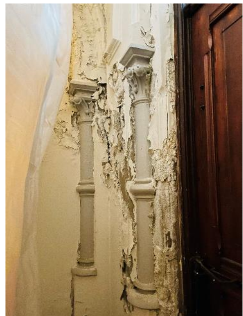
Bilde 45, Skader i våpenhus (retning sør-øst). Malingen henger i vaser pga. voksende saltkrystaller på pussens overflate. Pussen går helt i oppløsning.
