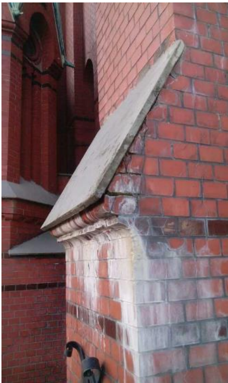
Bilde 50, Tilstand før utbedring i 2015
