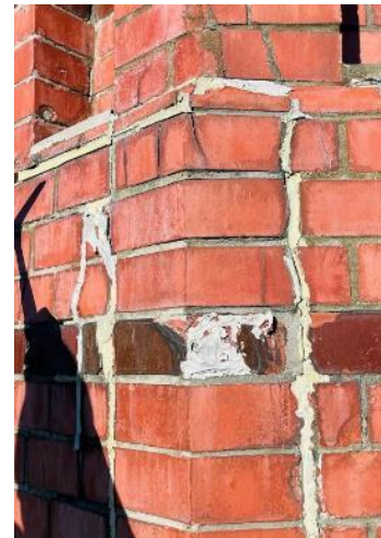
Bilde 24, Vertikale sprekker med akutte utbedringer
