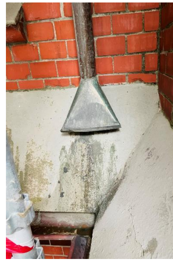
Bilde 58, Direkte fuktpåkjønning på utette betongavdekkninger gir fuktinntrengning.
