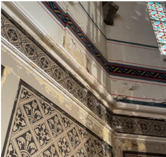
Figur 25, Saltutfellinger bak alter. Beslag utenfor i overgang tak/vegg er nylig utbedret.
