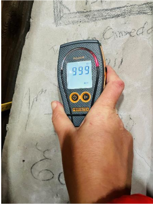
Figur 27, Fullt fuktutslag i pusset vegg inne i tårn. Pusset er antatt påført mellom 1894 og 1910.
