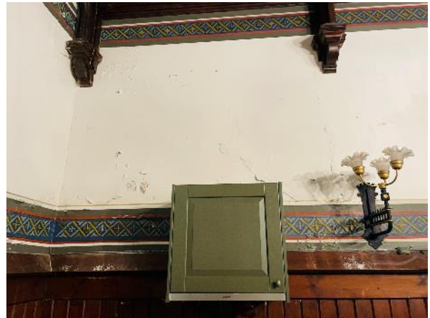
Bilde 36, Saltutfelling fra kafe 8himmelretning sør-søt). Utbedringer ble gjort i 2022 og det er på ny saltutfellinger og malingsavflassing
