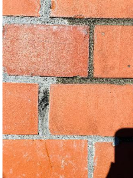
Bilde 20, fuktige fuger (det har ikke regnet). Antatt smeltevann fra is inne i murverket
