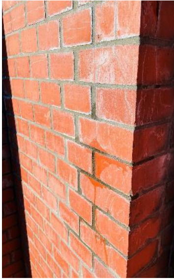
Bilde 19, Fukt som strømmet ut i solsteken i februar i fugene
