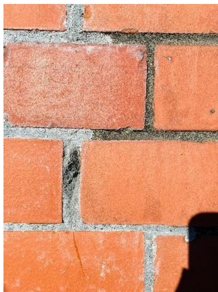
Bilde 39, Det lekker vann ut gjennom fuger (som forventet), men ikke overalt. Dette kan være impregnerte overflater eller at det ligger fuktsikring i et sjikt mellom flere spekkemørtler
