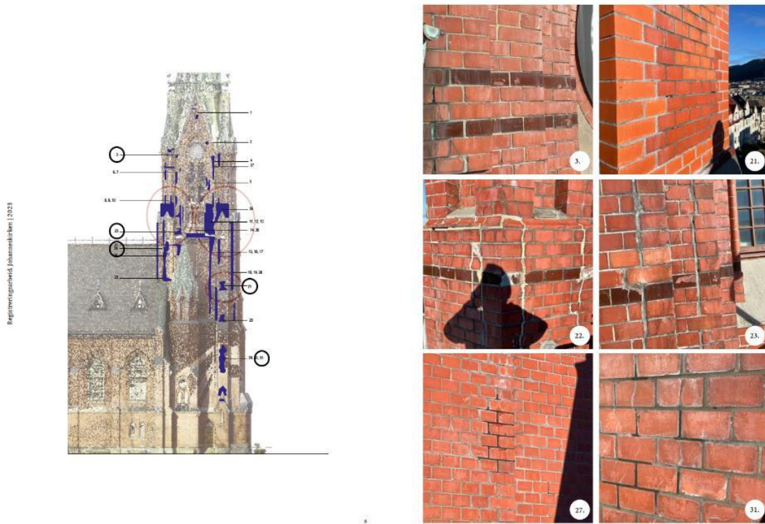
Figur 17, Fra vedlegg 1, Detaljert studie fra tilstandsvurderingen. Bilder og nummerering på tegning samt noe utfyllende tekst. Illustrasjonen vil være et godt verktøy for framtidig tilstandsvurdering samt detaljprosjektering. Se vedlegg Tilstandsregistreringen for detaljer.
