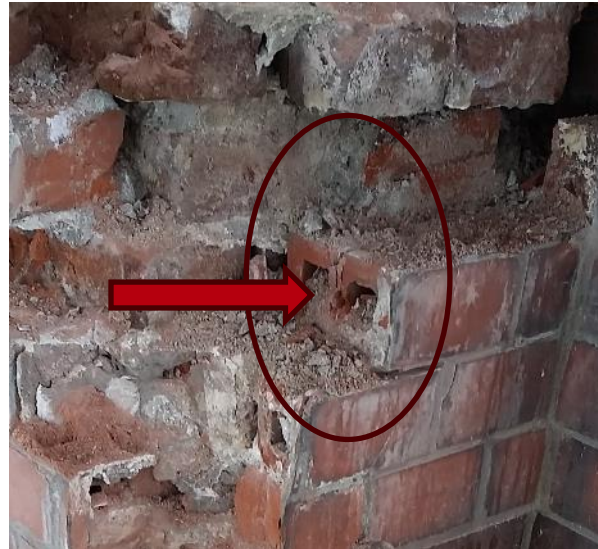
Bilde 31 (t.v.). Rød ring viser sprekk i tegl mellom hullene og ca. 6 cm inn i teglen.
