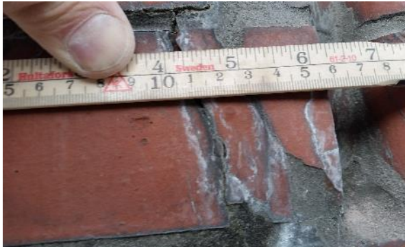
Bilde 30, Sprekk 5 cm fra ytterkant av tegl (Akasia, 2015)
