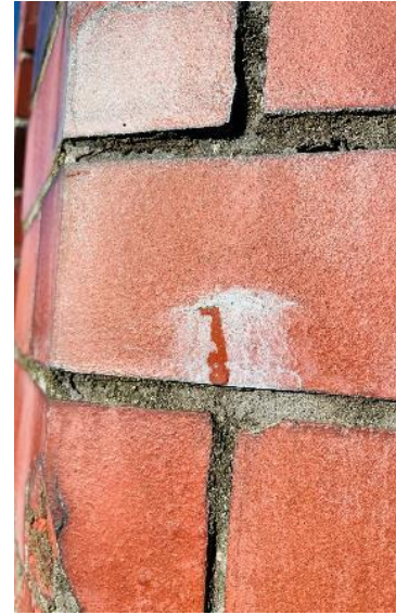
Bilde 21, Kalkutfellinger via et riss i fasadeteglen. Det renner vann gjennom teglen og ikke i fugen.
