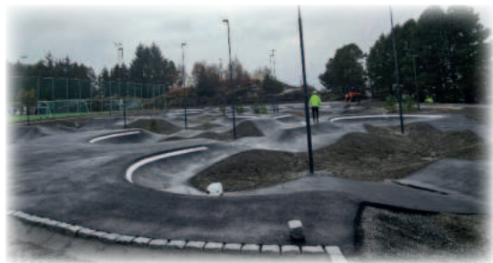
Pumptrackbanen under oppføring på det nye nærmiljøanlegget i Olsvik. Foto: Etat for idrett
