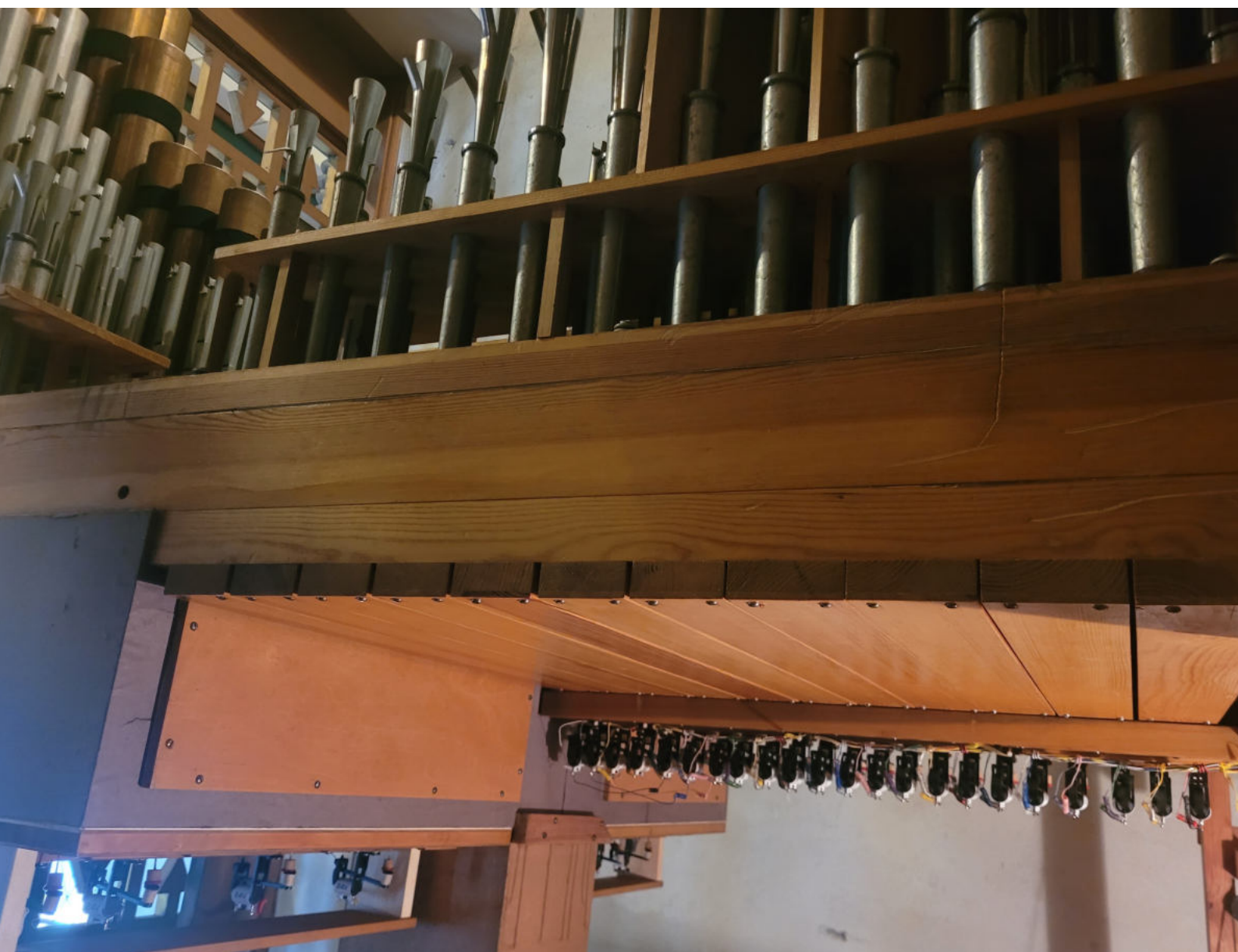
Nye elektriske komponenter sammen med piper fra 1939
