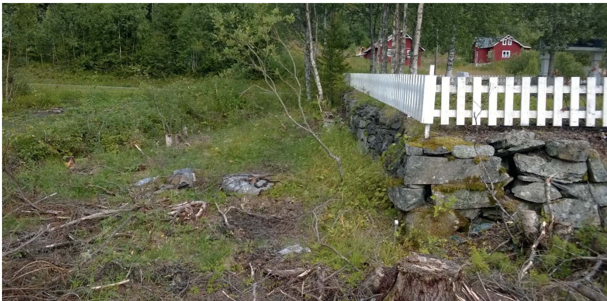
Bilete 8: Kyrkjegardsmur med lokal morenestein, eventuelt innkjøpt liknande stein (t.d. Hardangerskifer) og stakittgjerde oppå mur er tenkt vidareført inn i ny del.
