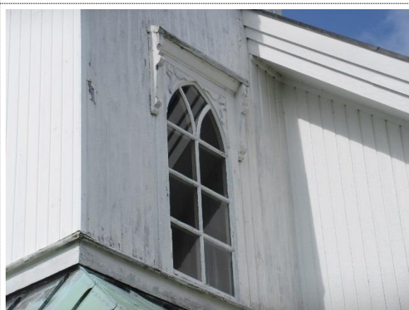
Bilde nr. 9 Kledningen på deler av tårnet er dårlig, likeså vinduene.
