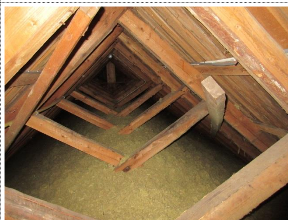
Bilde nr. 22 Isolert kaldloft over himlingen i skipet. Ingen synlige tegn på lekkasjer i undertaket.
