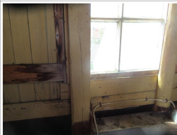
Bilde nr. 20 I klokketårnet er det tydelige tegn etter tidligere lekkasjer
