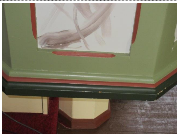
Bilde nr. 25 Noen mindre overflateskader/slitasje på prekestolen.
