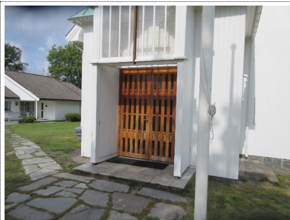
Bilde nr. 8 To-fløyet hovedinngangsdør i teak med behov for vedlikehold.
