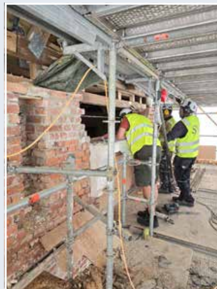
Utbedring av tårntak med bærekonstruksjoner og skader ved tårnluken.
