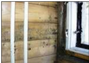
Muggsopp-skader som følge av oppfukning etter brannsløkking.
