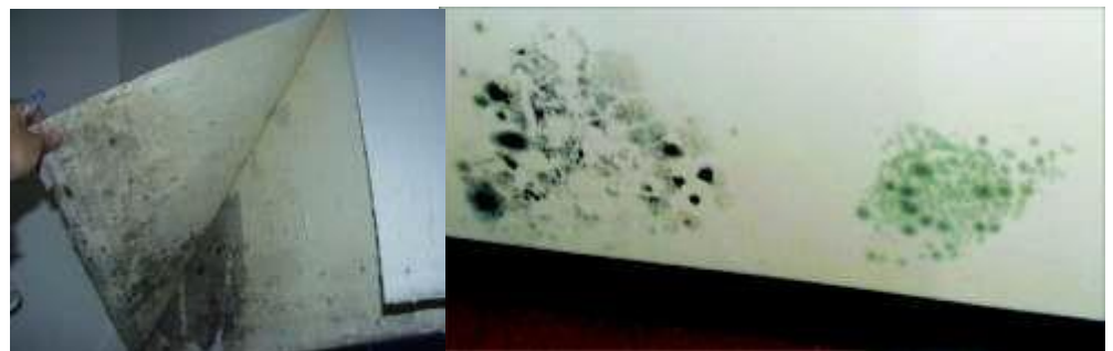
Vekst av muggsopp på gipsplate
