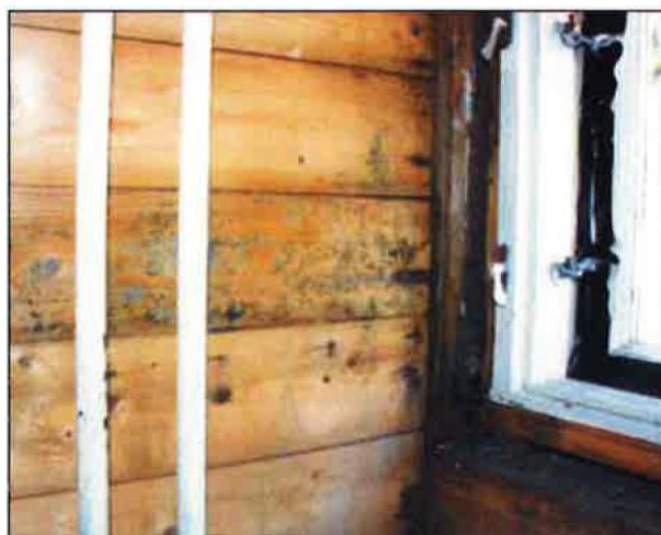
Muggvekst som en følge av kondensering av varm, fuktig luft på kalde flater.
