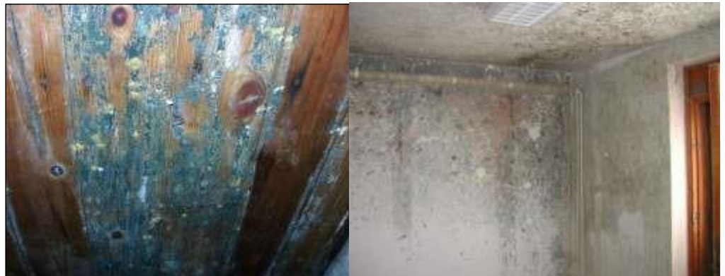
Muggvekst etter vannlekkasje.
