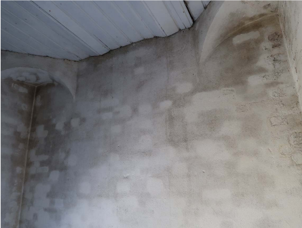
Foto 3: Fra inne i tårnet. Tydelig tilsmussing og annen misfarging viser omriss på stein. I hjørnene er det salt- og kalkutslag som viser at det er fuktinntrenging utenfra.
