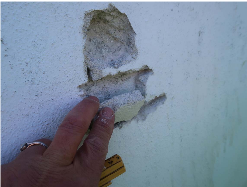
Foto 10: Prøve 9A ble tatt 1,3 m opp på veggen, mellom vinduene nærmest tårn vest (se forrige bilde).
