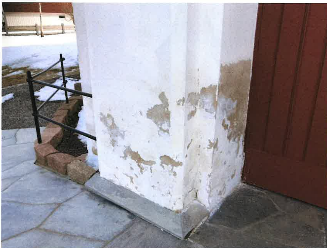
FIGUR 9. SALTUTFELLINGER SYNLIG I NEDRE 1 METERS BELTE I TILKNYTNING TIL TRAPP OG INNGANGSPARTI, TÅRNETS VESTVEGG. DE FORSTERKEDE SKADENE LOKALT I DETTE OMRÅDET ANTAS FORÅRSAKET AV SALTING VINTERSTID. (FOTO: MUR OG MER, MARS 2021).
