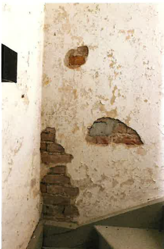
FIGUR 10. TEGN PÅ FUKTIGHET I KONSTRUKSJONER: BORTFALL AV PUSS OG MYE MALINGSAVFLASSING I NEDRE DEL AV TRAPPEROM. SEKUNDÆR SEMENTREPARASJON SYNLIG I SKADE (FOTO: MUR OG MER, MARS 2021).
