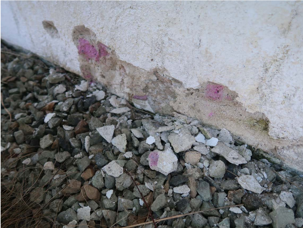
Foto 11: Fra fasade nord. Prøve 9 B/C, tatt ved sokkel/terreng. En pH indikator (fenolftalein) ble også påført. Rosa områder indikerer liten karbonatisering og vanligvis nyere reparasjoner med høy hydraulisk andel. Ingen fargeforandring indikerer at pussen er gjennomkarbonatisert.
