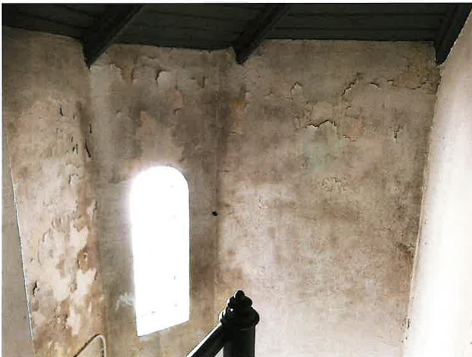
FIGUR 11. TÅRNET HAR MYE MALINGSAVFLASSING PÅ VEGGENE. SÆRLIG I ØVRE DEL MOT TAK OG I HJØRNER. DETTE SKYLDES KOMBINASJON AV FUKTTILGANG/ STÅENDE FUKTIGHET I KONSTRUKSJON OG DIFFUSJONSTETTE OVERFLATER. PLASTMALING? (FOTO: MUR OG MER, MARS 2021).
