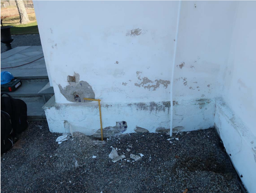
Foto 5: Fra sydsiden på tårnbygg, ved inngangspartiet. Prøve 4 (A-B-C-D-E) og prøve 6 (A-B) ble tatt her. Prøvene 4B/4C/4D ble tatt rett over sokkel. Prøve 6A ble tatt fra løs avskalling v/terreng. Prøve 6B ble tatt 1,4 m opp fra terreng (rett over øvre billedkant).
