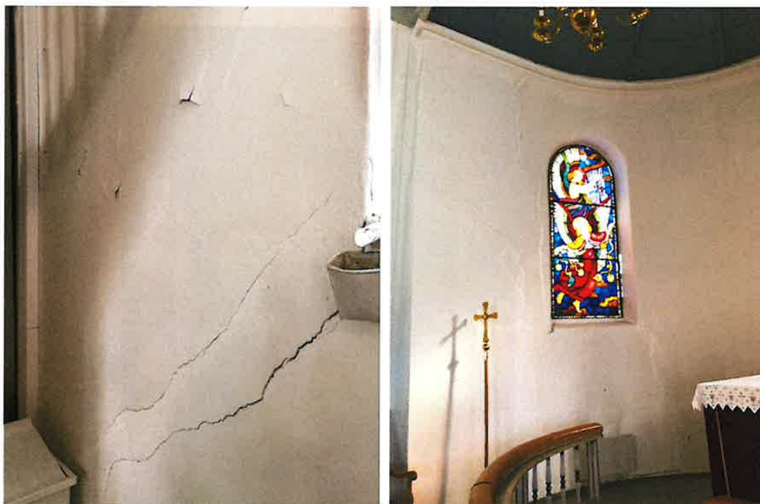
FIGUR 13. SETNINGSREVNENE ER AKTIVE, OG ER I DAG PRIMÆRT SYNLIG I KIRKEROMMET. T.V. REVNER UNDER GALLERI, NORDVEGG. T.H. REVNER I NORDRE DEL AV APSIS (REPARERT/ HVITE). REVNENE ER GJENNOMGÅENDE FRA GULV TIL TAK. (FOTO: MUR OG MER, MARS 2021).
