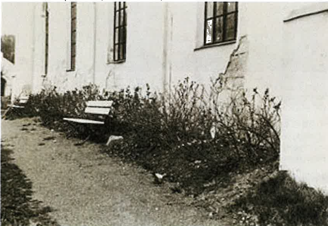
FIGUR 3. SYDVEGG. LØS PUSS SOM ER FJERNET ELLER FALT AV I NEDRE DEL AV VEGGEN BLOTTLEGGER KVADER- OG BRUDDSTEIN GJENBRUKT FRA TIDLIGERE KIRKEBYGG. (FOTO: RA V/ CATO ENGER 1956).
