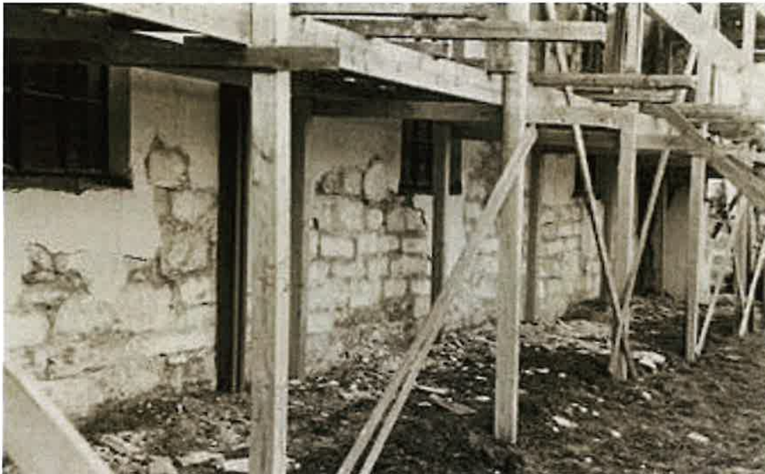
FIGUR 2. FJERNING AV PUSS/ PUSSREPARASJONER PÅ NORDVEGGEN I 1956. DET KOM DA FREM SYNLIGE KVADER- OG BRUDDSTEIN MED FLERE LAG OVERFLATEBEHANDLING/ KALKSLEMMING SOM BLE ANTATT Å VÆRE GJENBRUKT FRA ET TIDLIGERE KIRKEBYGG. ( FOTO: RA V/ CATO ENGER 1956).
