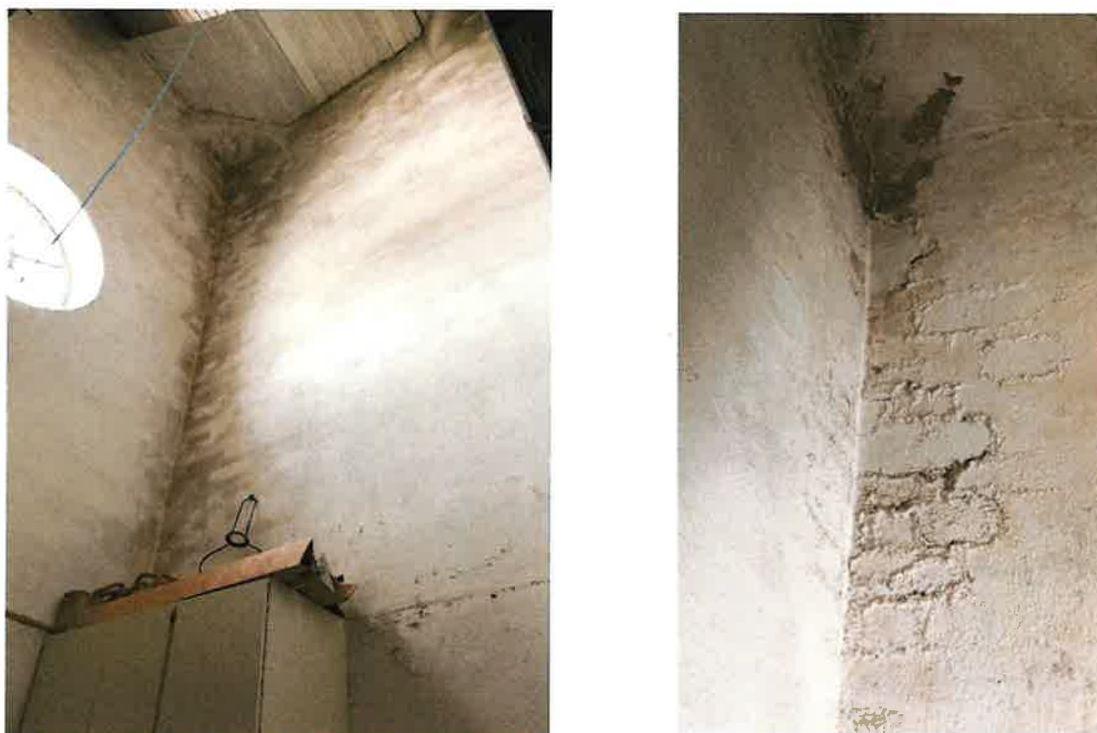
FIGUR 12. TÅRNET: SALT OG SKITT AVSATT I HJØRNENE PÅ GRUNN AV DÅRLIG OPPTØRNING I VEGGKONSTRUKSJONENE. (FOTO: MUR OG MER, MARS 2021).
