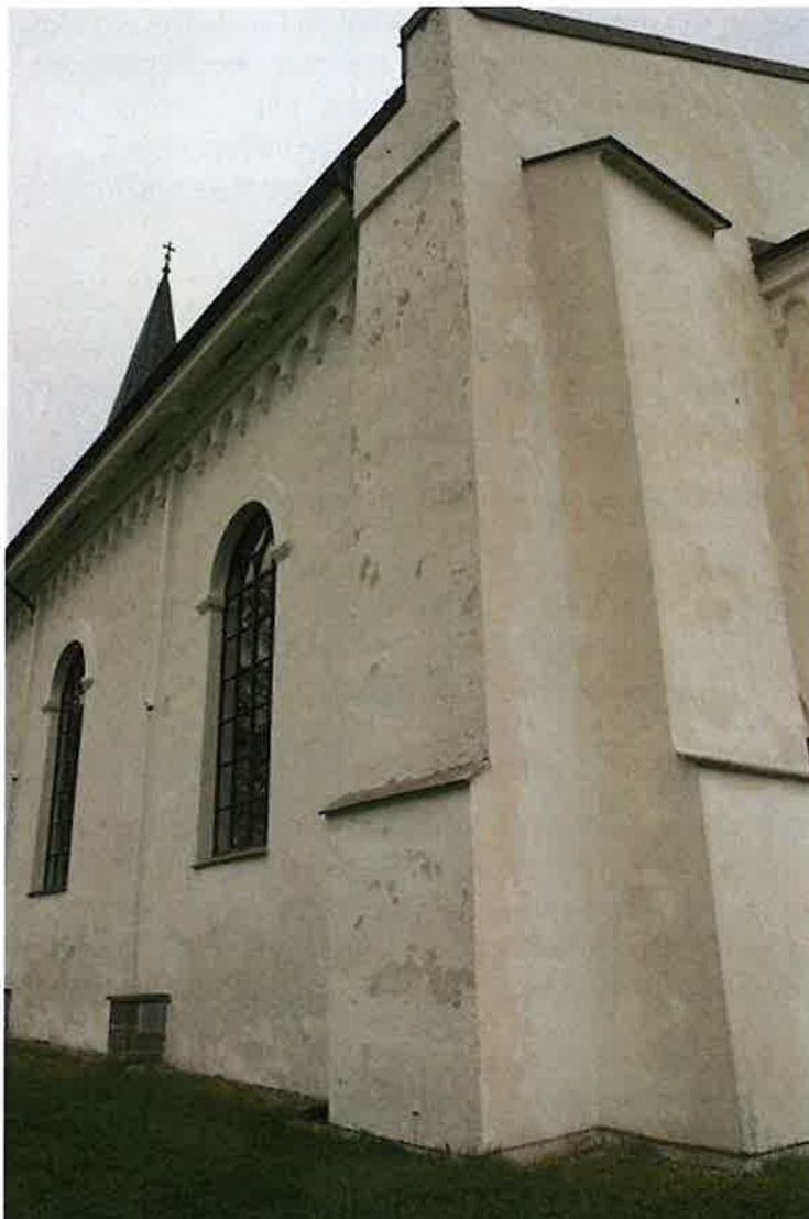
FIGUR 6. NYE SKADER SYNLIGE I OVERFLATEBEHANDLINGSLAG, SYDØSTRE HJØRNE. (FOTO: RA v/ H. EGEDE NISSEN, AUGUST 2015).
