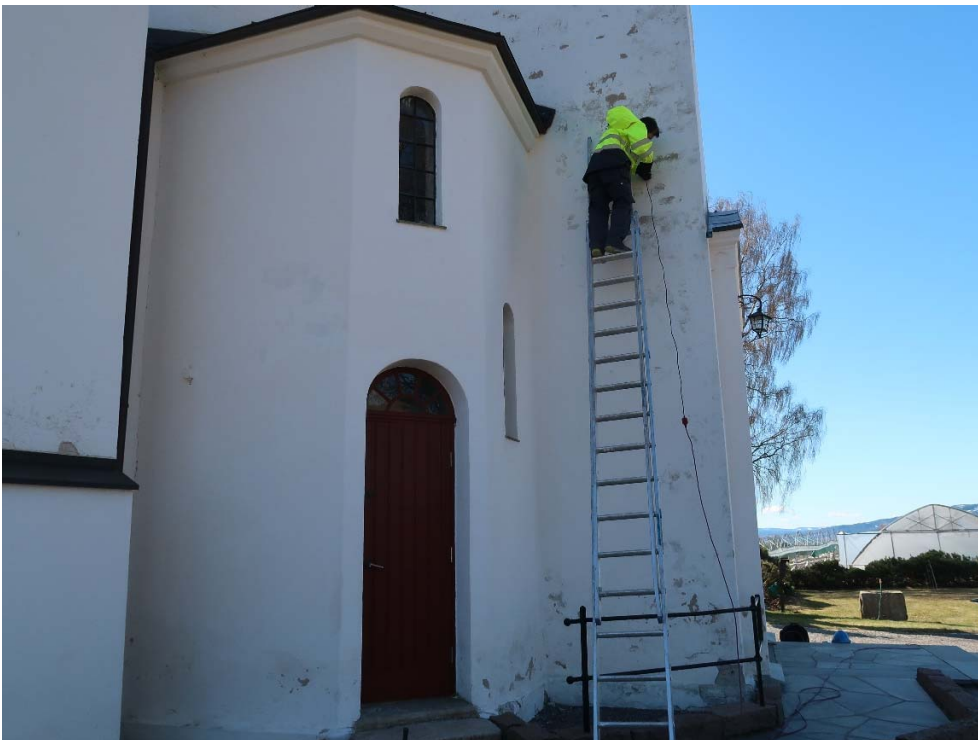
Foto 6: Prøve 5 ble tatt et stykke opp på nordsiden av tårnbygget.
