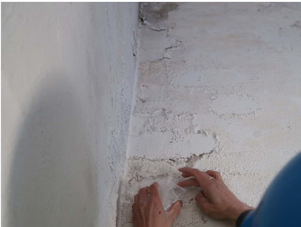
Foto 4: Prøve 3 ble tatt av løse utfellinger på veggoverflaten i et hjørne inne i tårnbygget.
