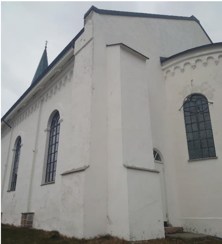
Fig.22: Under vinduer der vannet drypper
