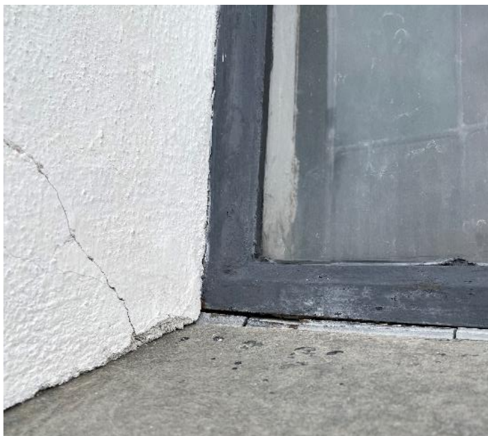
Fig.33: skiferplate ikke ført langt nok opp under bunnkarm i vindu.
