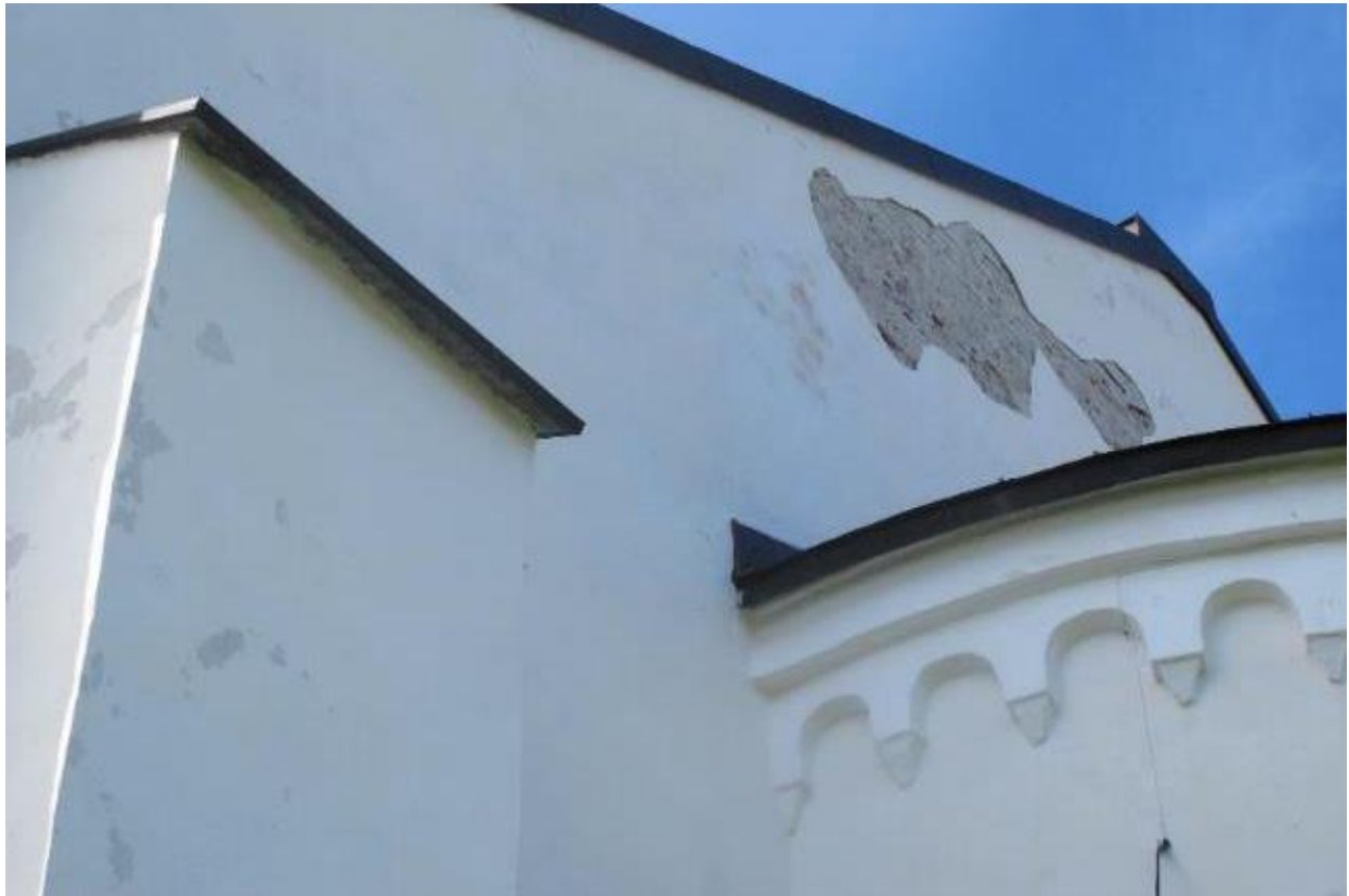
Fig.29: Frostskade førte til at et større parti løsnet i østgavlen i 2013.
