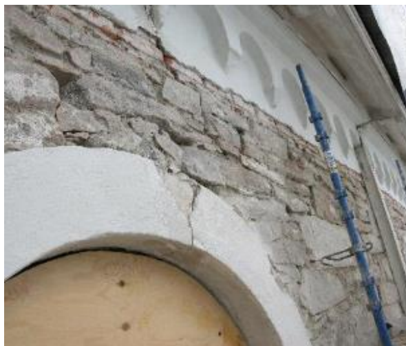
Fig.4: Gesims og omramning ble ikke hugget i 2010. Opp mot gesims ligger to skift med teglstein.
