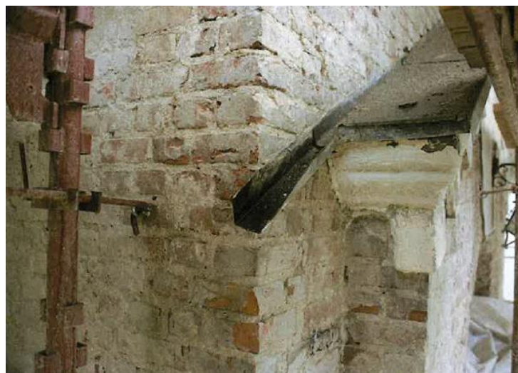
Fig.10: Uskadet teglstein etter hugging. Foto H. Ibenholt RA
