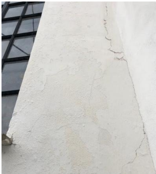
Fig.26: Gjentatte sprekker mellom bygningsdeler.
