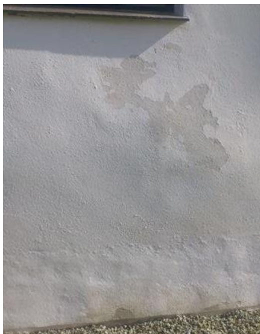
Fig.13: Fargeforskjellen skyldes overflatens tekstur og forskjellen i mørteltypene. Avflakingen over er drypp fra skifer sålbenken.
