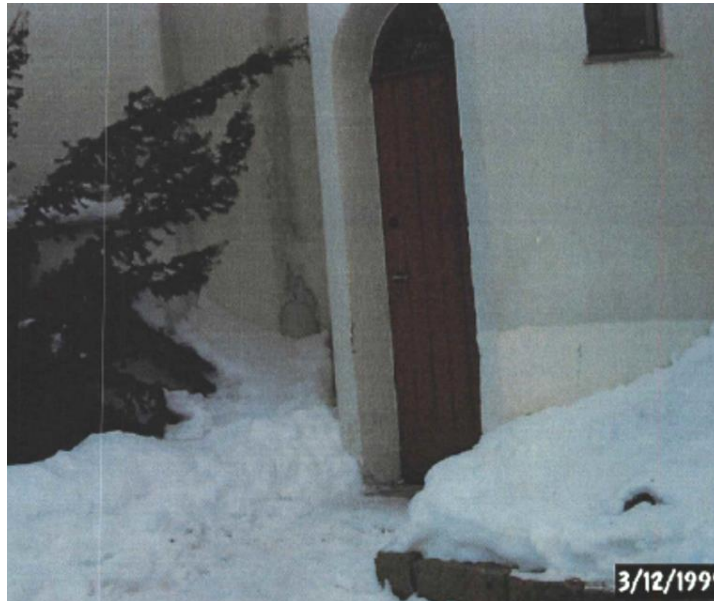
Fig.25: Abel Engh dokumenterte i 1999 fuktforholdene inntil veggen mot vest.
