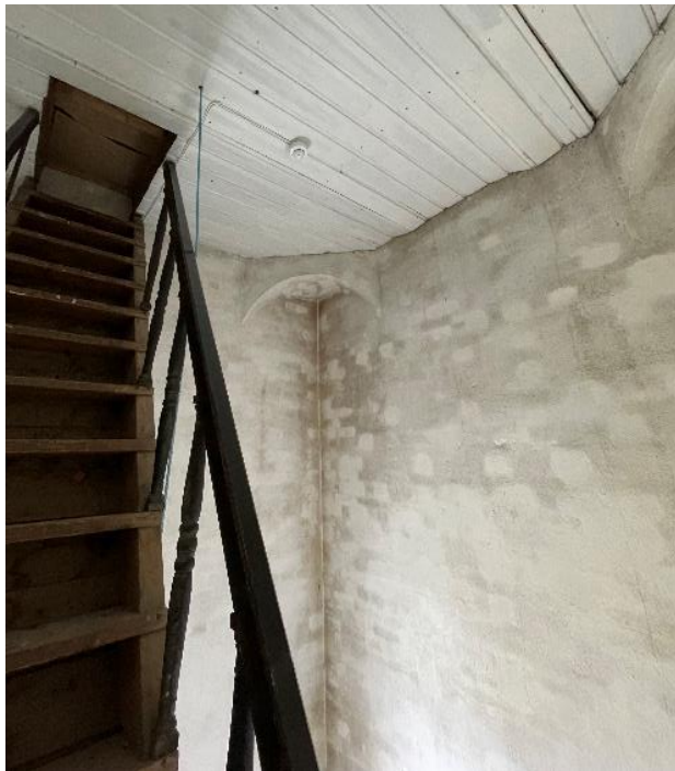
Fig.31: Tårnet har tydelig mye fukt som ikke slipper ut. Treverk er ikke skadet.
