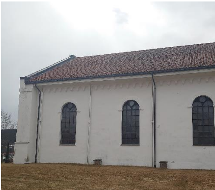
Fig.19: Kirken fra nord. Tydelige skader på NV hjørnelisene og i tårnet.
