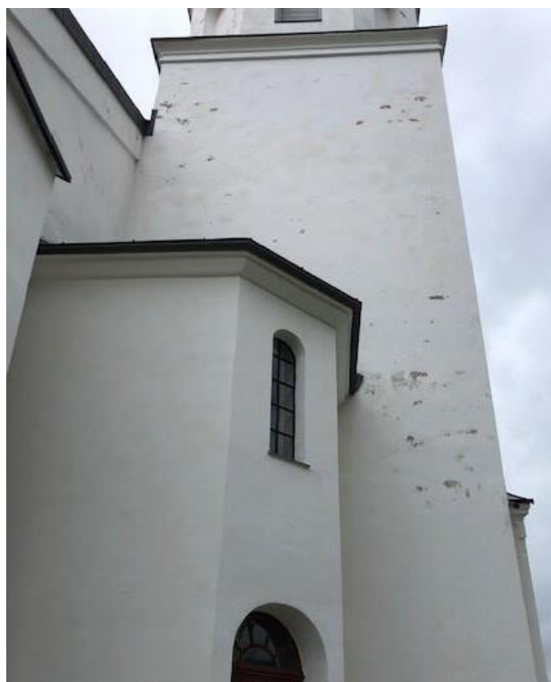
Fig.15: Avskallinger på nordsiden av tårnet i 2019
