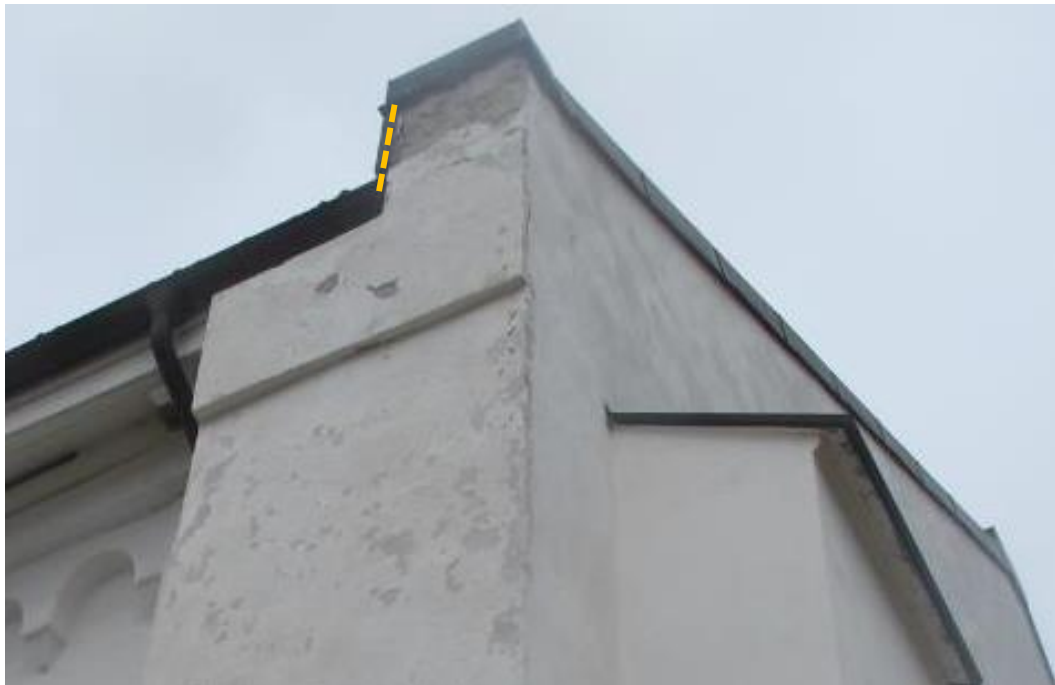
Fig.35: Typisk skade i ende av murgavler. Dette har vært et område med gjentatte skader. Her bør det lages en avrenning direkte ned i takrenne, se stiplede linje.
