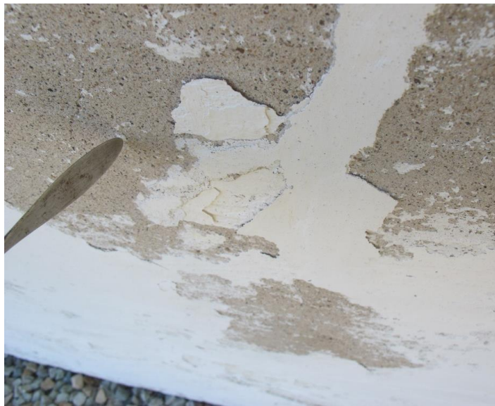
Fig.27: Salt og frostskadet puss.
