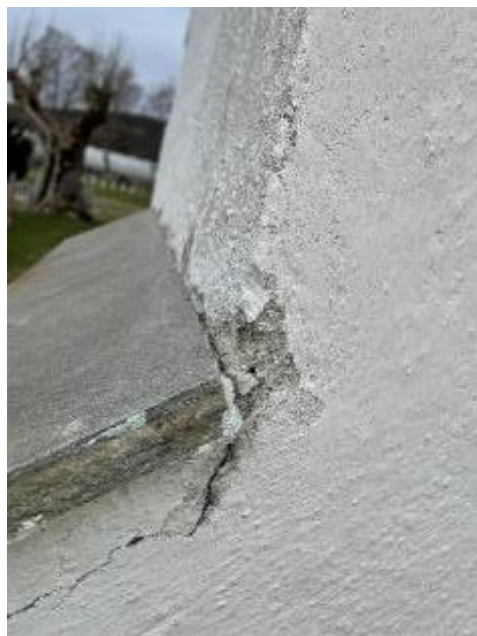
Fig.34: skiferplate ikke ført langt nok opp i pussen.
