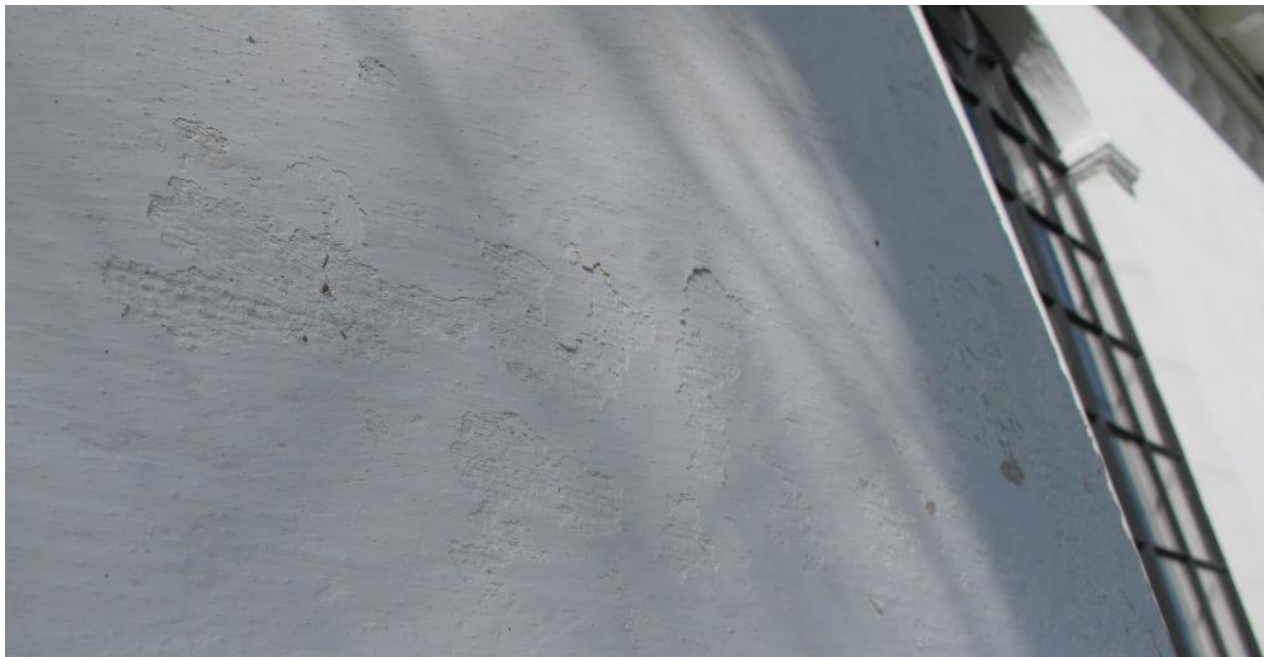
Fig.30: Avflaking av kalkhvitting på pilaster. Tykke kalklag bør åpnes opp slik at underlaget er fast og med åpne porer.
