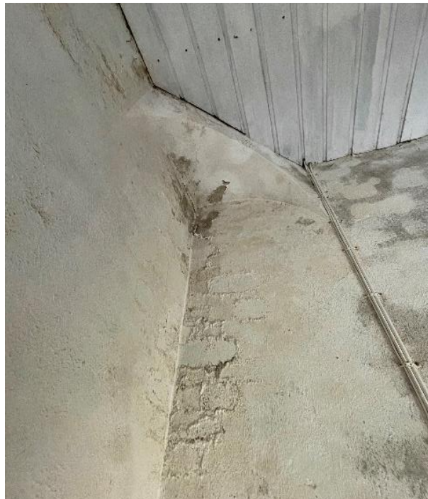
Fig.32: Fugene er våte, og de har mye støv og alger. Malingen inne bør fjernes kjemisk.
