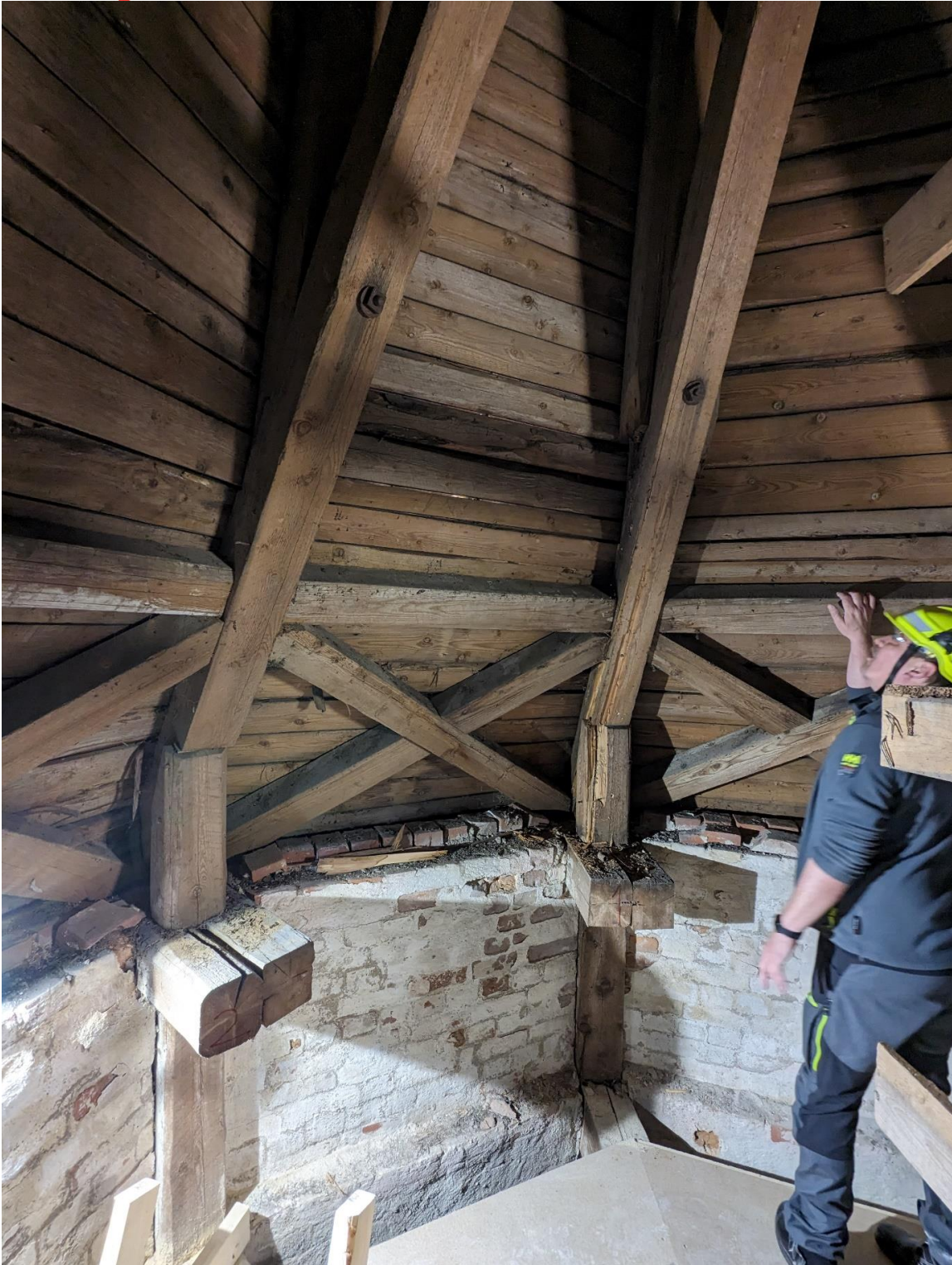
I nr. 1 er det råte i både bjelke og sperre. Avskallinger i teglstein. De øverste 12 skiftene er 1 ½ stein. Under det er det 2 steins tykkelse på veggen.
