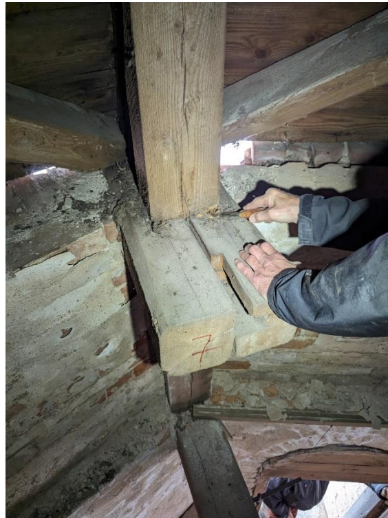
Undersøkelser inne i spiret 06.07.23 ved overgang mellom taksperrer og gesims.
