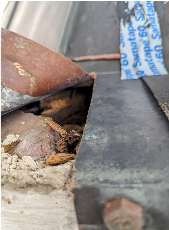
Skaden ble tydelig ved kontrollåpning av nederste del av kobbertekking på spir.
