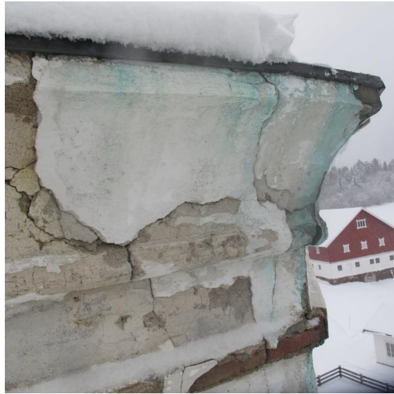
Detalj som viser at tekkingen ligger inntil gesimsen.
