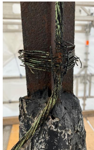
Koblinger i ståltråd er gjennomkorrodert.
