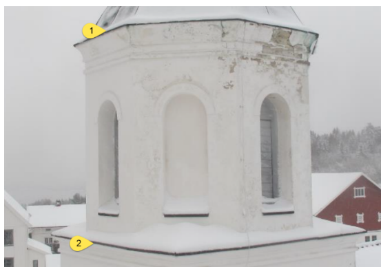
Foto 11: Områder med overganger mellom beslagsløsninger og taktekkning må prosjekteres for å redusere risiko for skader i framtiden.
