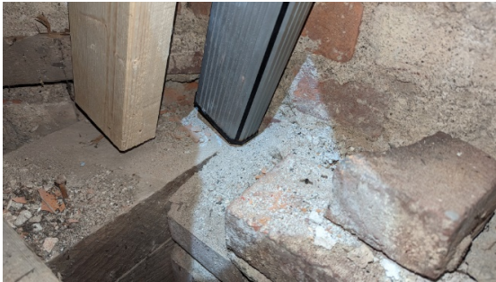
Foto 8. Bjelke O1. Venstre side av bjelkehode er vanskelig tilgjengelig på grunn av skrå mur og støttebjelke.
