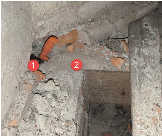
Foto 2 (råte i innmurte deler)
