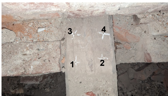
Foto 5. Bjelkers opplegg er råtedrillet ved fire punkter som vist i foto. Merk at indre del av bjelken ikke er råtedrillet i denne omgang, men det er tidligere påvist råteskader i innmurte deler (fra punkt 3 og 4 og innover i vegg).
