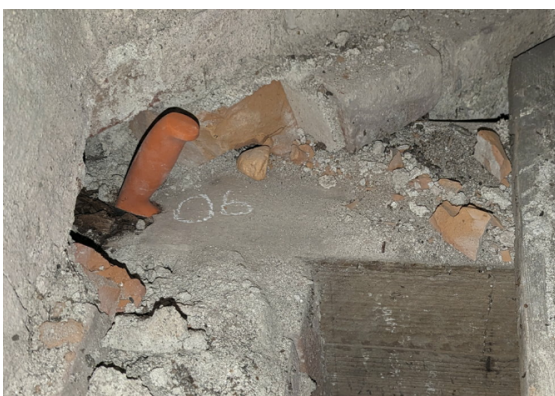
Foto 10. Overliggende bjelker er råtedrillet systematisk for å avklare gjenværende reststyrke. Se avsnitt 4.2
