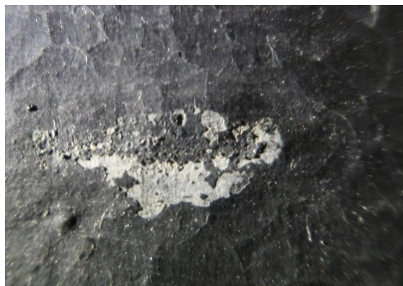
Figur 63. Detalj av skade med hvitt materiale som enten er en undermaling eller et sekundært materiale.
