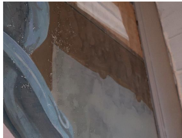
Figur 58. Detalj av fuktskjolder og avskallinger på maleriet av Johannes.
