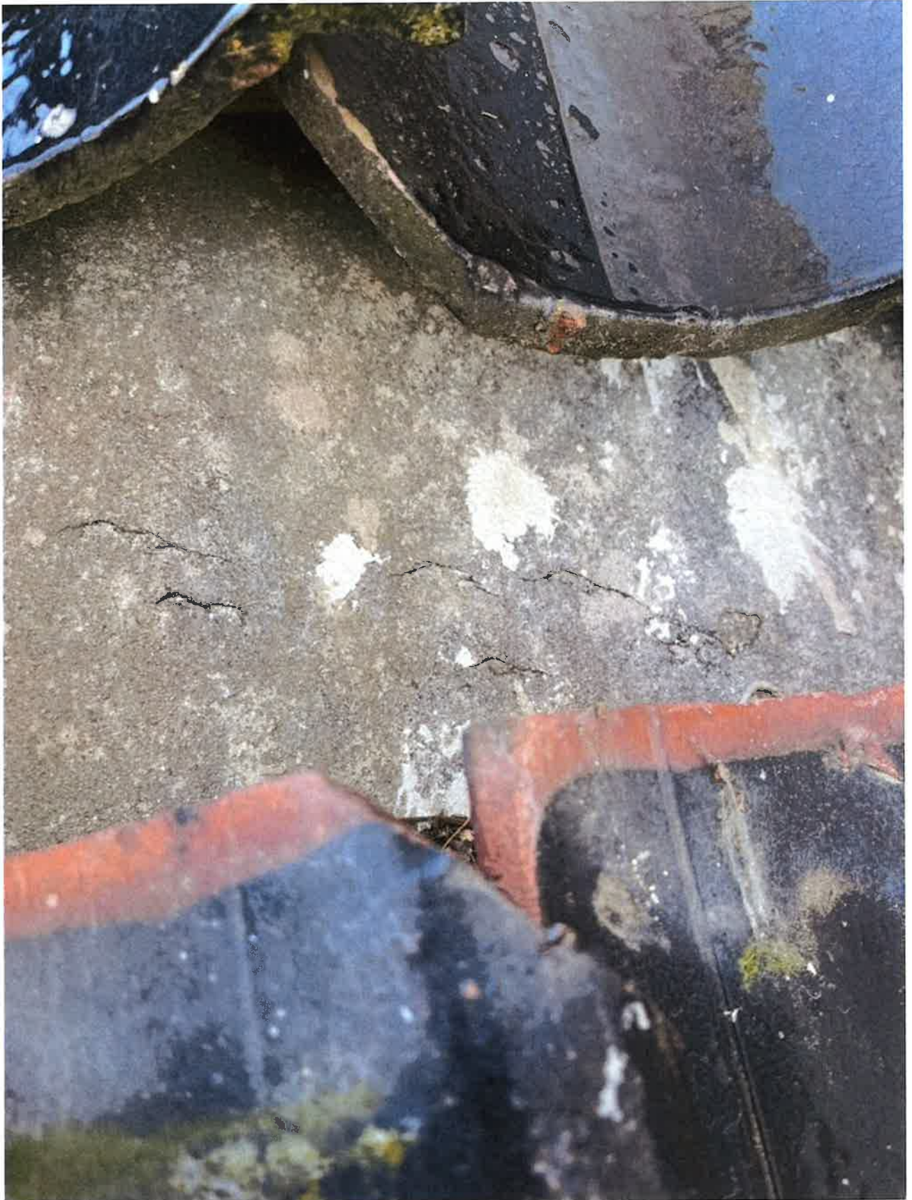
underlagsspapp med sprekkdannelse
