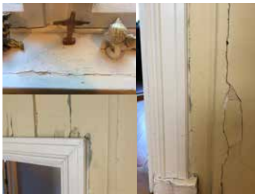
(Bilde over viser 3 eksempler på skader i nåværende bygg i Akersbakken 30.)
